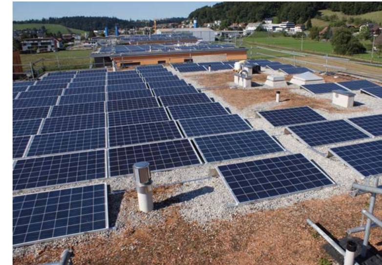
MFH Auweg 45/51/53, Heimberg. Netzgekoppelte Photovoltaik-Flachdachanlage. Solarmodule Trina Honey. Gesamtleistung: 48,2 kWp.
